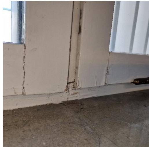
Foto 4 Färgsläpp samt smutspartiklar på fönster pga. luftläckage
