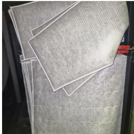
Foto 6 Nya fräscha tilluftsfilter i ventaggregat
