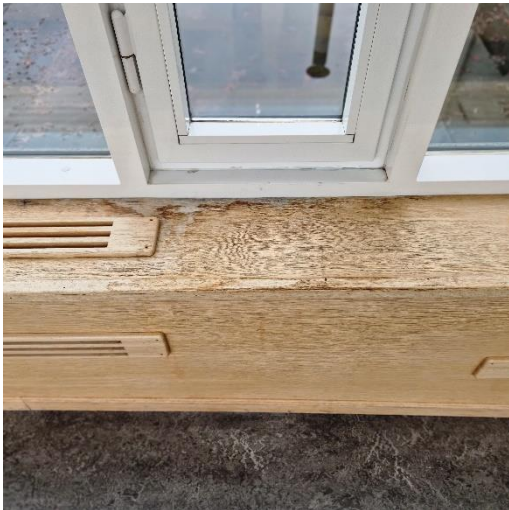
Foto 3 Fuktrosor/missfärgningar i passage
